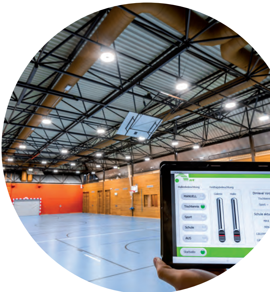
LED-Projekt Häuselgrundhalle Zuzenhausen
